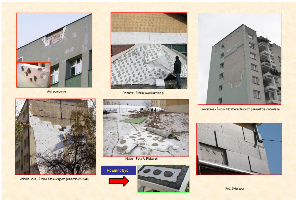
Fot. 13÷18 Skutki błędów wykonawstwa prac dociepleniowych
